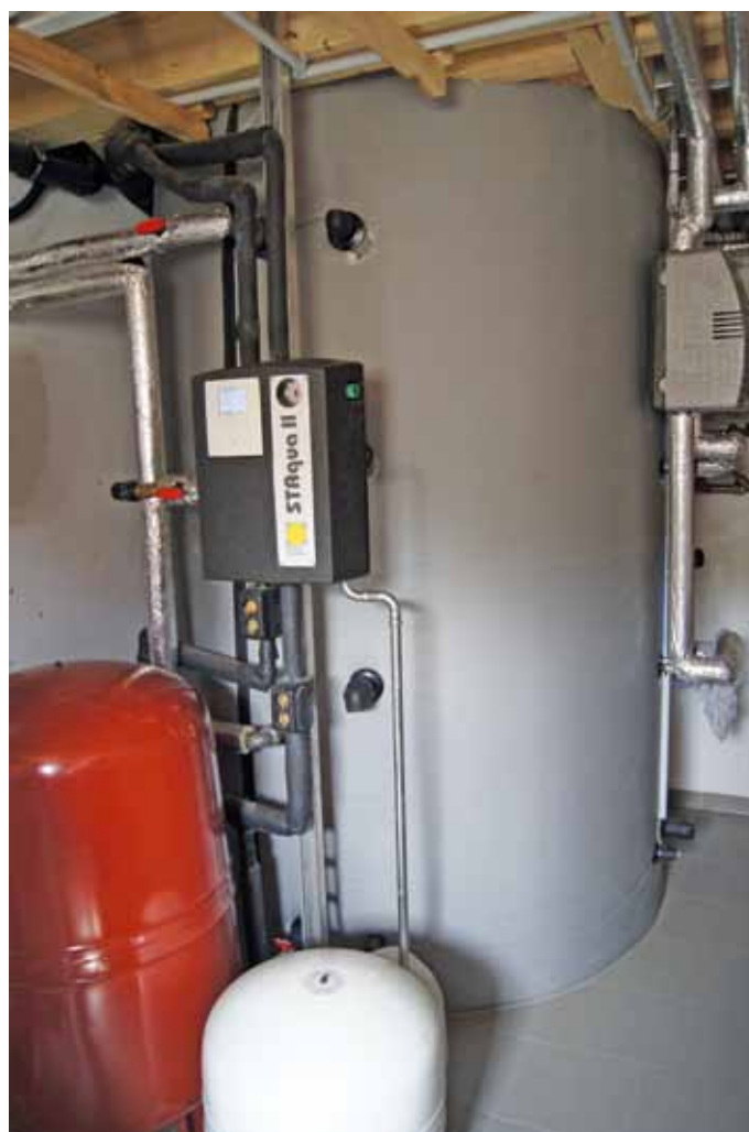
Der Solar-Pufferspeicher mit einem Nennvolumen von 3000 l befindet sich in der Haus-technikzentrale; Bild: Stefan Schön
